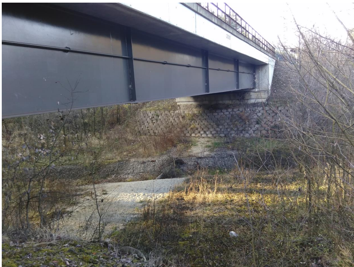
Obr.4.: Podchod pro zvěř na železničním koridoru mezi Českou republikou a Slovenskem.
